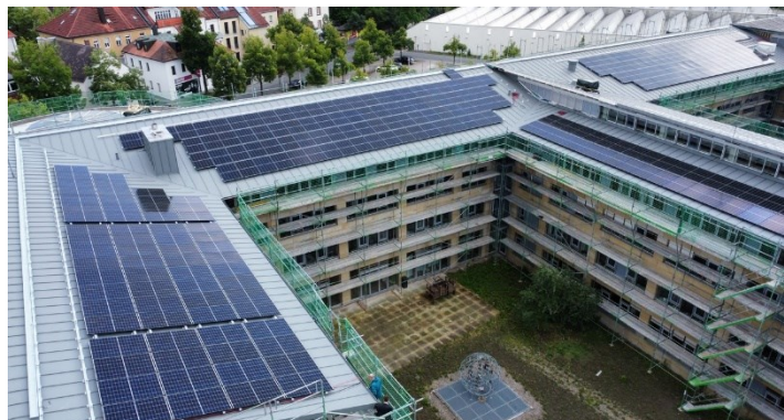
Die größte PV-Anlage auf kreiseigenen Liegenschaften wurde 2024 auf dem Landratsamt installiert. © Landkreis Bayreuth
