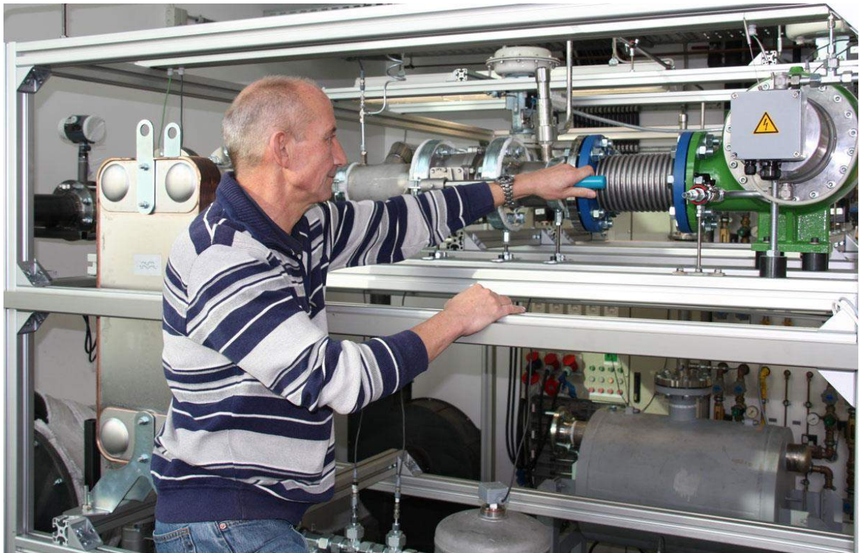
Abbildung 97: Andreas Obermeier von der Uni Bayreuth vor einer ORC-Anlage, die für Biogas-BHKWs eine neue Möglichkeit der Abwärmenutzung eröffnet.
