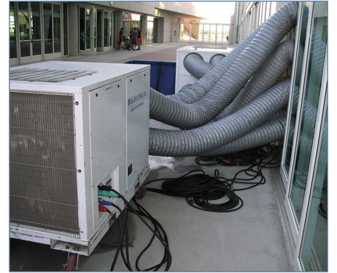
Provisorische sommerliche Gebäudeklimatisierung (Quelle: Ben Loomis / flickr.com)
