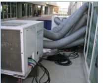
Provisorische sommerliche Gebäudeklimatisierung (Quelle: Ben Loomis / flickr.com)
