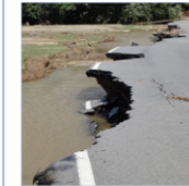
Unterspülte Straße bei Bautzen (© Julian Nitzsche / PIXELIO)
