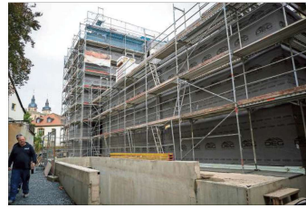
Stattkirche in Sichtweite, die Regierung in direkter Nachbarschaft: Das höchste leimierte Holzhaus Bayerns wächst in der Ludwigstraße. Zum Schutz gegen das Wetter ist der Holzhauseingang geschützt. Foto: Eric Waha
