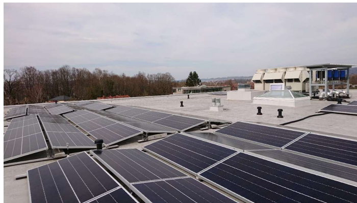
Blick aufs Dach mit Dach-PV, Wechselrichtern, VRF-Anlage
