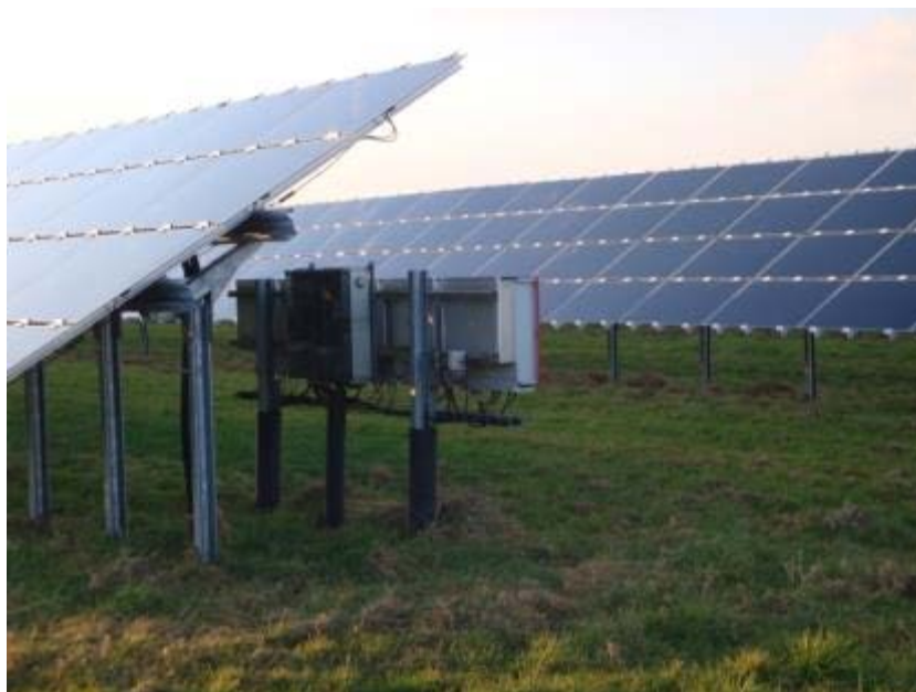
Abbildung 23: Wechselrichter müssen vor einer Schafbeweidung umzäunt oder anderweitig gegen Verbiss gesichert werden (Foto: K. Gerdes, Solarpark Fliegerhorst Oldenburg).
