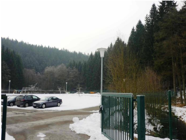
Abb. 21: Außenbeleuchtung auf dem Kläranlagengelände mittels Pilzleuchten .
