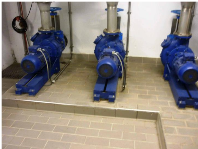
Abb. 6: Zulaufpumpen im Untergeschoss des Betriebs-/Rechengebäudes
