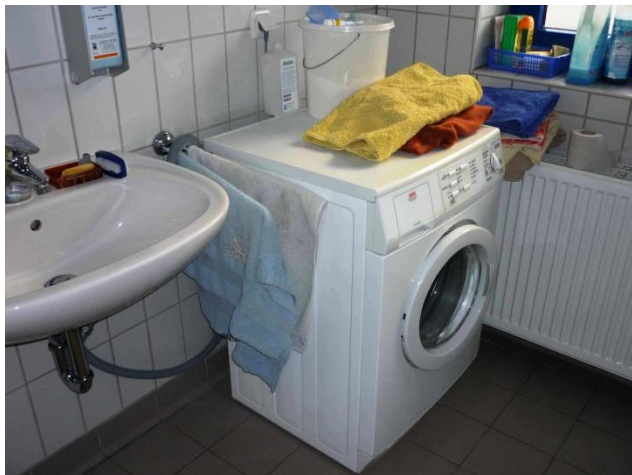
Abb. 26: Waschmaschine im Betriebsgebäude
