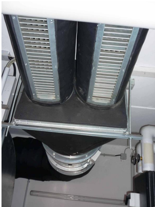
Abb. 32: Lüftungsauslässe im Heizraum
