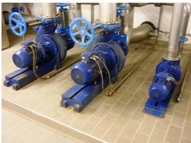
Abb. 9: Rücklaufschlamm-pumpen (linke u. mittlere Pumpe) und Überschussschlamm-pumpe (rechts)
