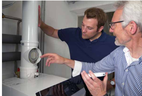
... zur neuen Heizung: Information und Beratung vor Ort
