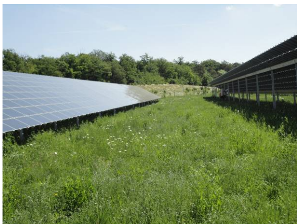
Abb. 33: Großzügige Abstandsflächen zwischen den Modultischen
