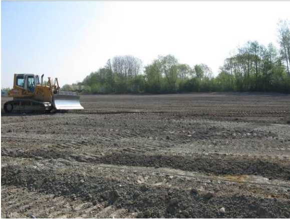
Abb. 36: Bauphase; Zustand nach Rückbau der Vornutzung © Linke + Kerling, Stadtplaner und Landschaftsarchitekten BDLA
